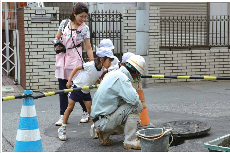
園の前で行われている工事。マンホールの中ってどうなっているんだろう。ちゃんと覗けないからこそ想像が膨らむ。
